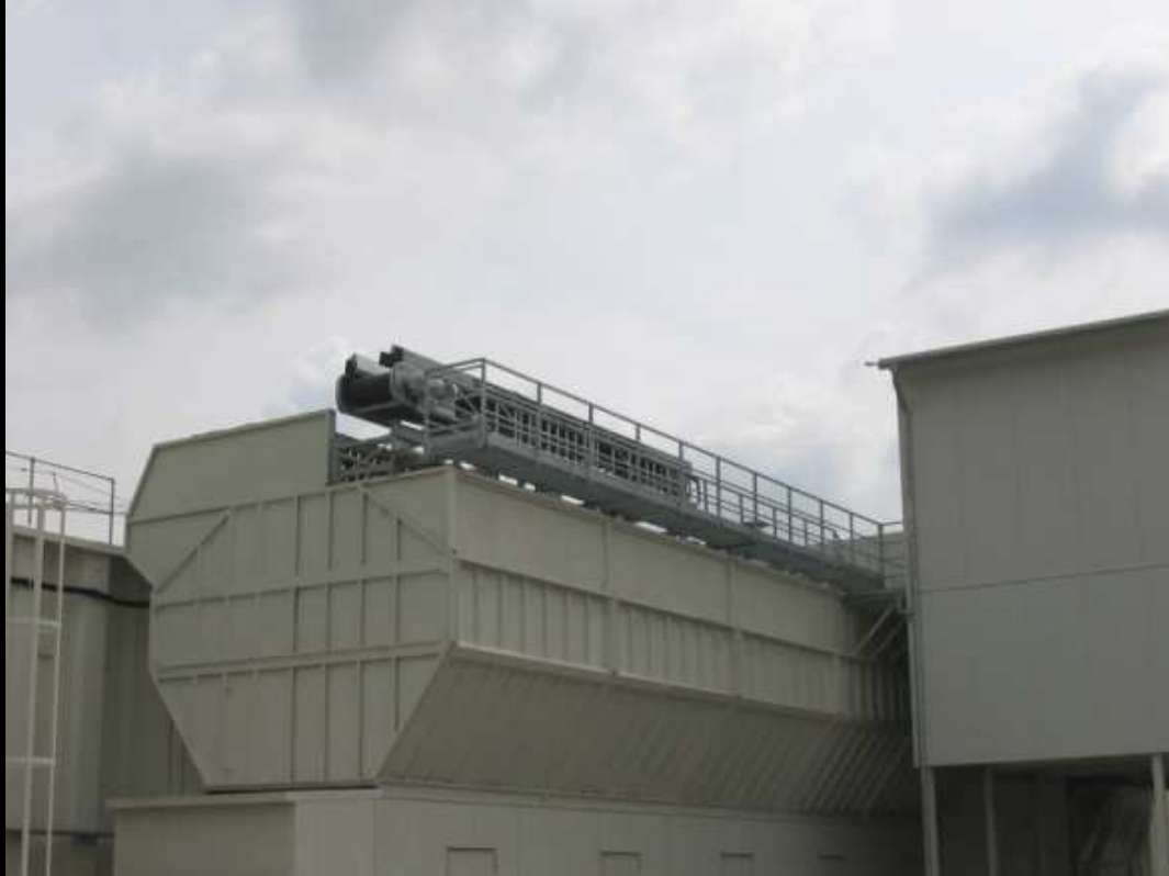
Verteilerband (Baugruppe RF) verfahrbar auf Schienen
